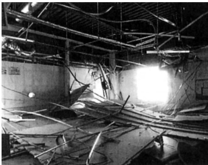
天井材の脱落
